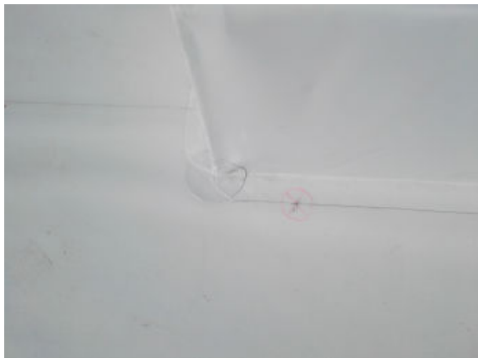
Obr. č. 2 Lokalizovaná netesnosť 1 na streche RD1
