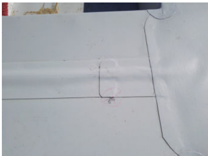
Obr. č. 4 Lokalizovaná netesnosť 3 na spoločnej atike RD2 a RD3
