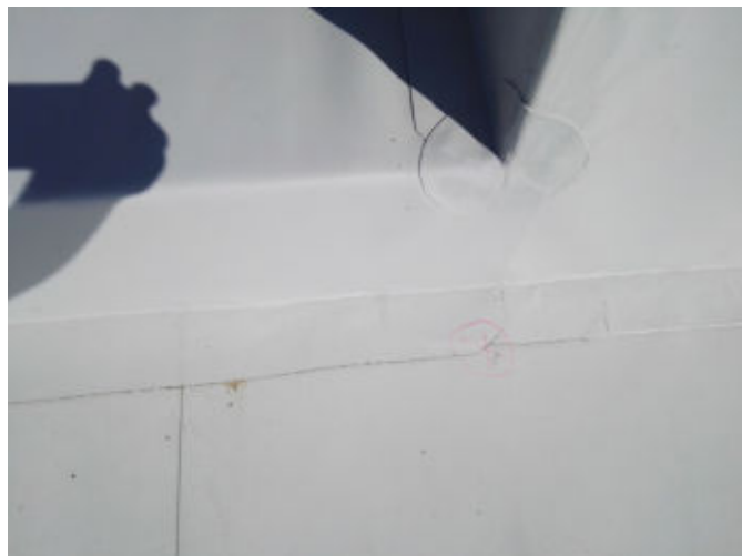
Obr. č. 3 Lokalizovaná netesnosť 2 na streche RD1
