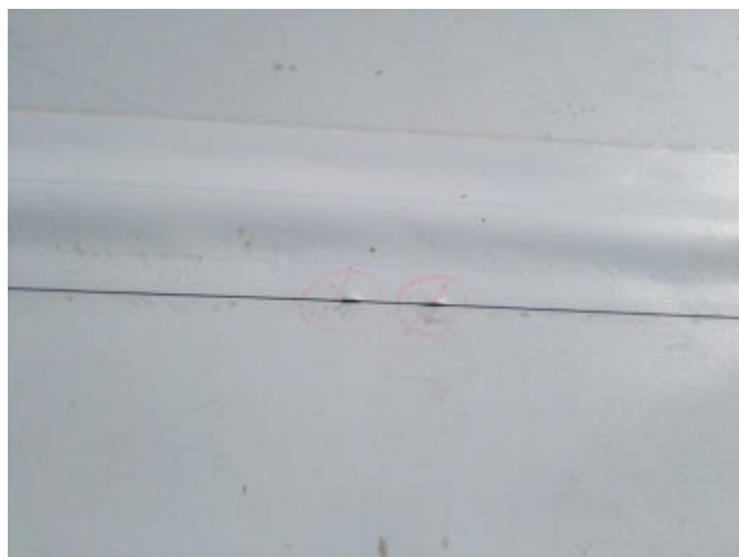
Obr. č. 5 Lokalizovaná netesnosť 4 a 5 na spoločnej atike RD2 a RD3
